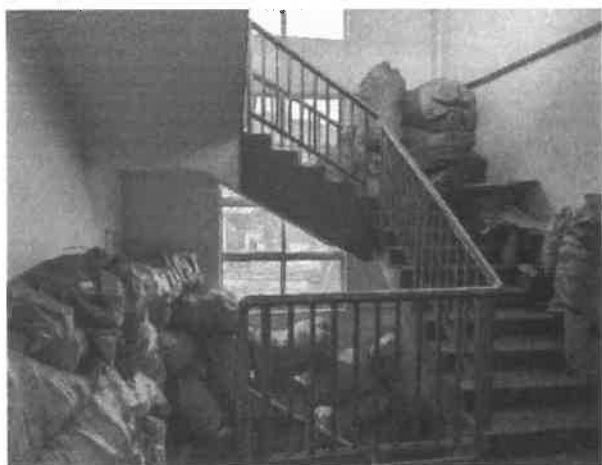
图 1 楼梯堆放杂物，堵塞疏散楼梯
