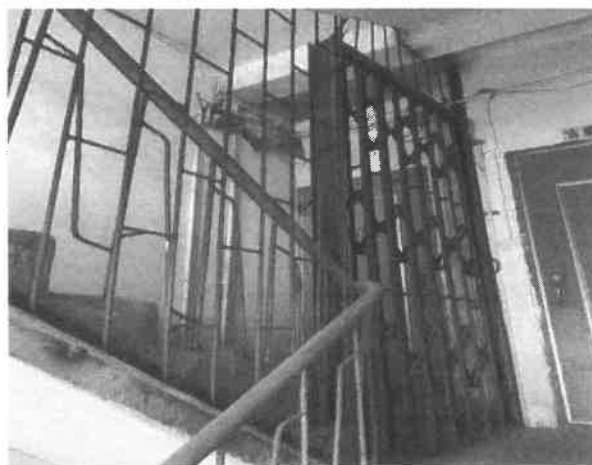
图 2 在疏散楼梯上安装铁门，影响疏散
