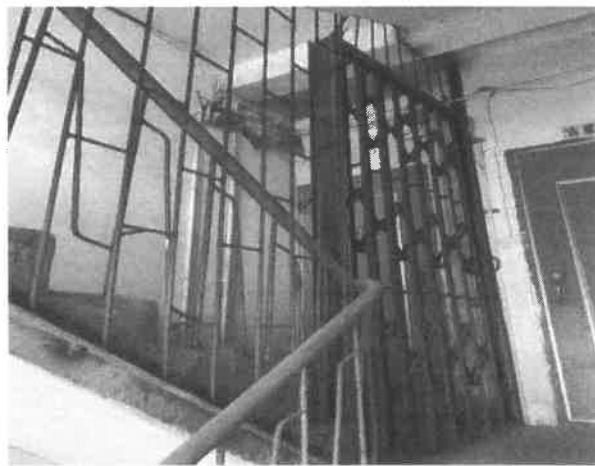
图 2 在疏散楼梯上安装铁门，影响疏散
