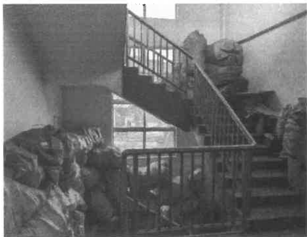
图 1 楼梯堆放杂物，堵塞疏散楼梯
